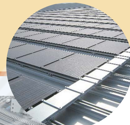
太陽光パネル
